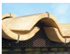
Grille métallique bas de versant T 235
